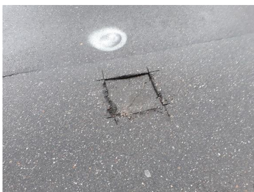
Figuur 2 - oneffenheden in het wegdek
